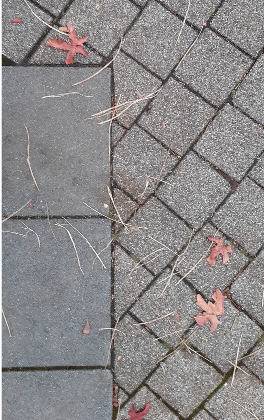
Kaiserslautern, Paul-Ehrlich-Straße Gehweg
